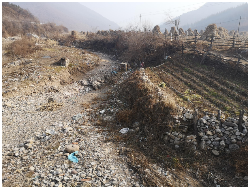
局部河堤无护砌，农田侵占堤线
