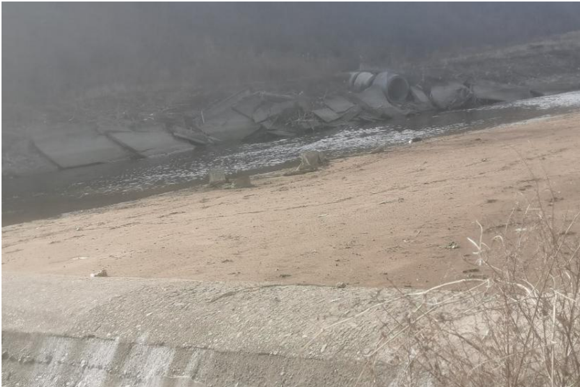
图 2.2-9 巨流河河道局部段原有防护破损现状图
