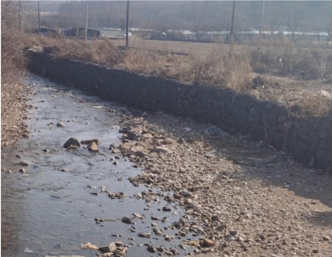
图 2.2-8 巨流河河道两岸固滨笼防护
